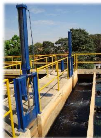
Entrada para tanque de filtros
