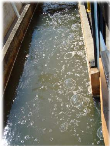
Entrada dos Floculadores
