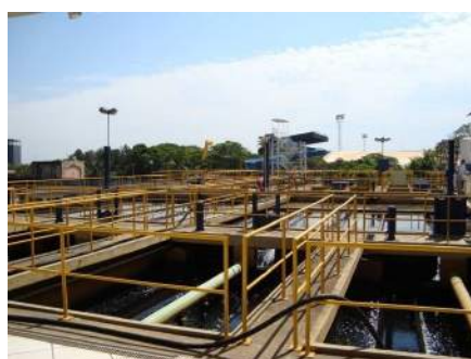
Sistema de tratamento de água
